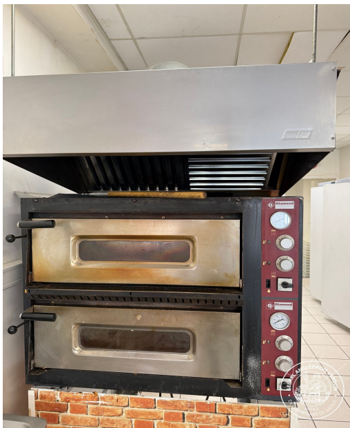
1 Hotte inox 1 m x 1 m (au dessus du four)
